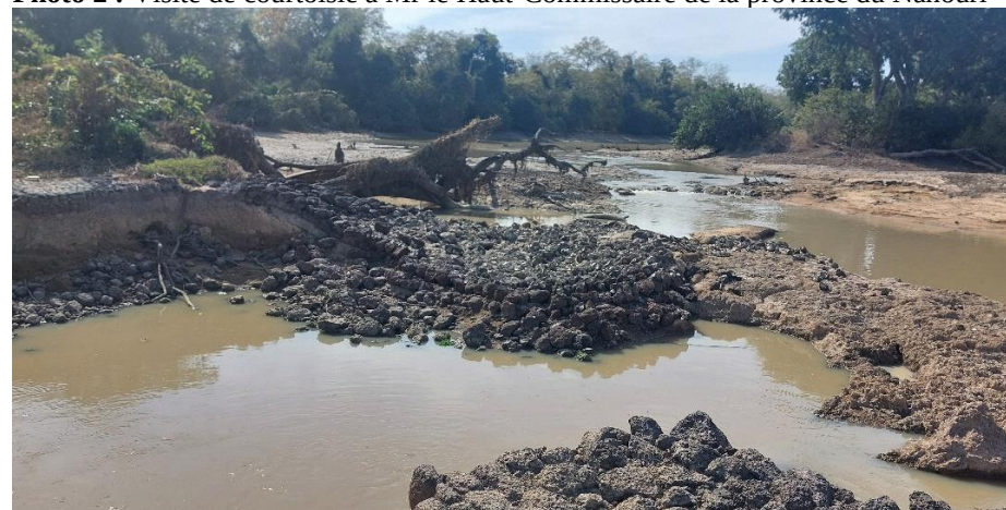
Photo 4 : Digue cédée du Barrage d'Akwazena qui nécessite une réparation urgente
